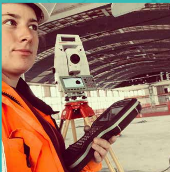
Projet de rénovation d'un bâtiment à La Haye, aux Pays-Bas, avec une station totale Leica TS16, par Marijke De Cleer.
